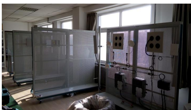
图 2. 通信工程实训平台
