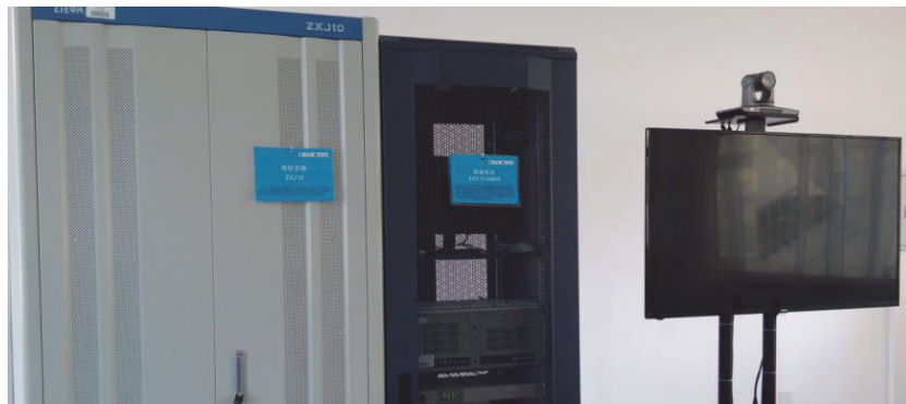
程控交换技术实训平台
